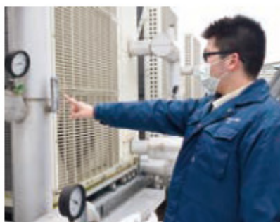
設備更新後も定期的に機器の正常運転を確認しています
