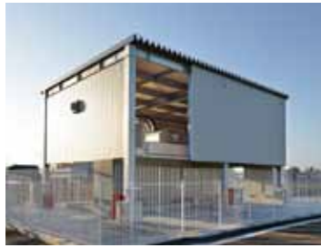
北側駐車場に配備した自家発電機
